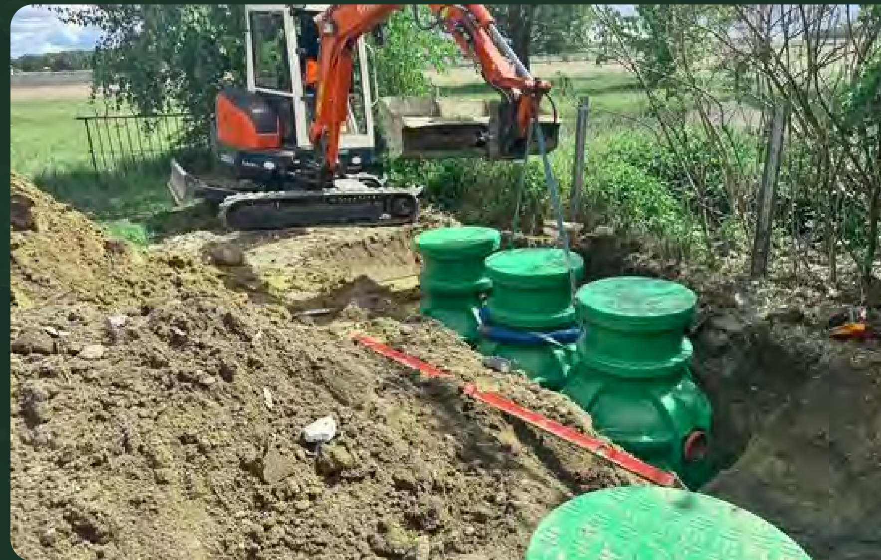
Oczyszczalnia biologiczna BIOTECH 15
