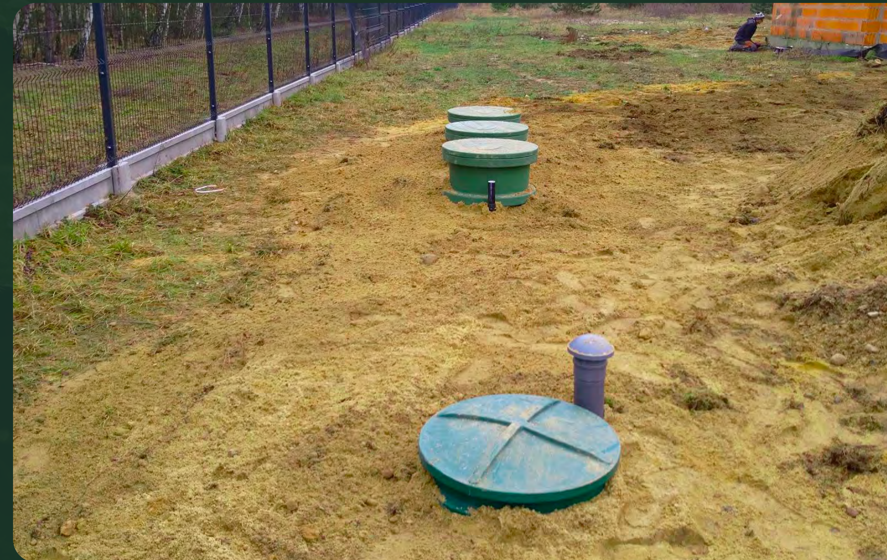
Oczyszczalnia biologiczna BIOTECH 6
