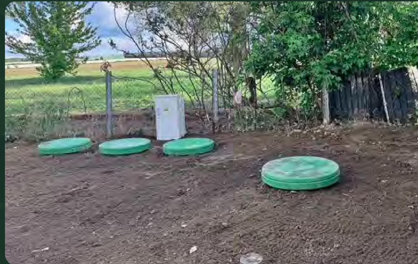
Oczyszczalnia biologiczna BIOTECH 15
