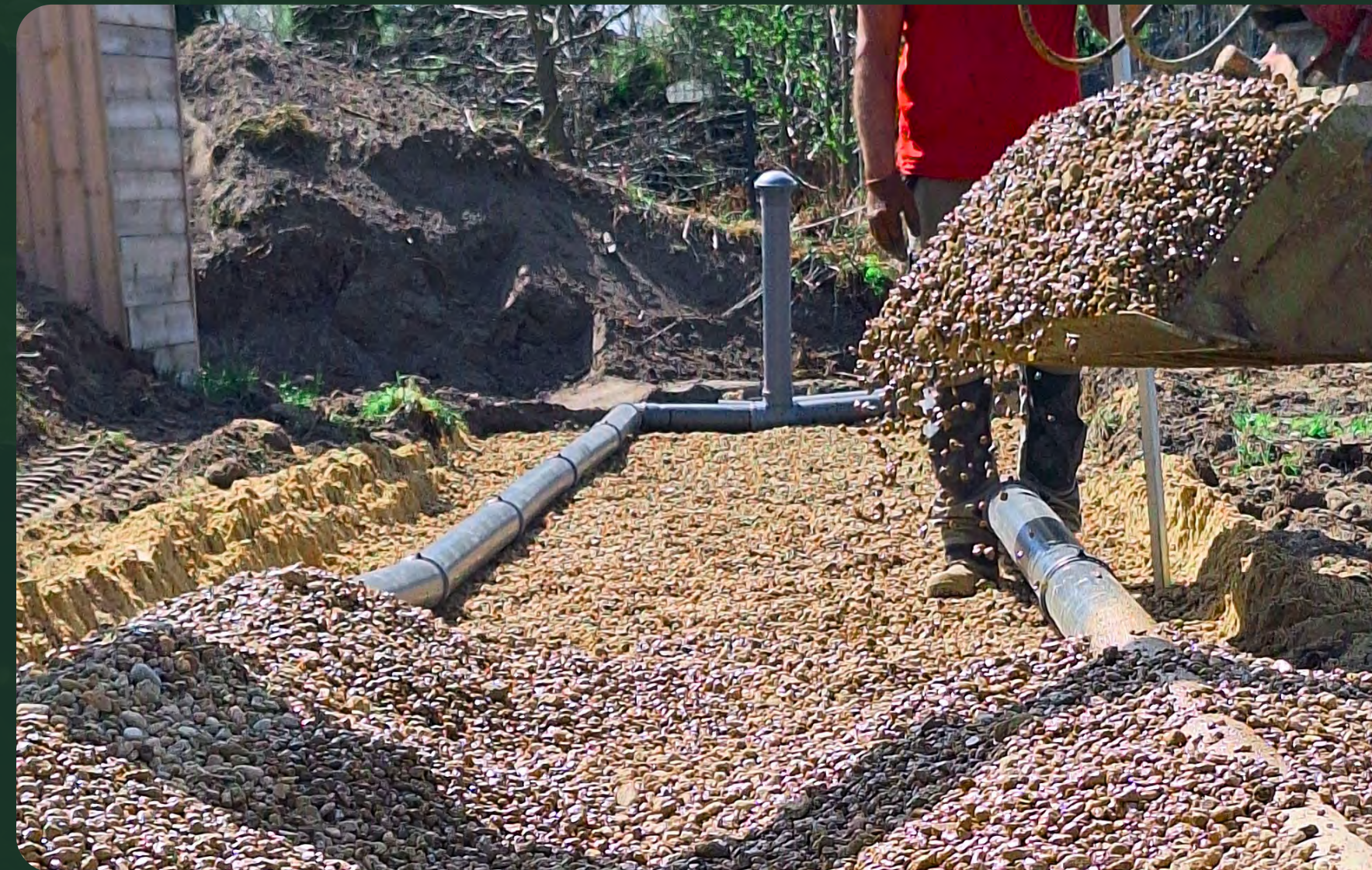
Oczyszczalnia biologiczna BIOTECH 6 IPS z drenażem w nasypie
